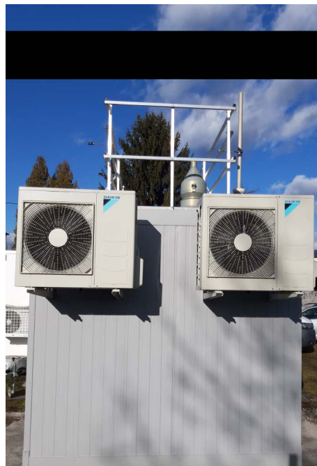
Abbildung 4: Klimaanlage des Messcontainers sowie der Innenraum des Messcontainers. (© Umweltbundesamt)
