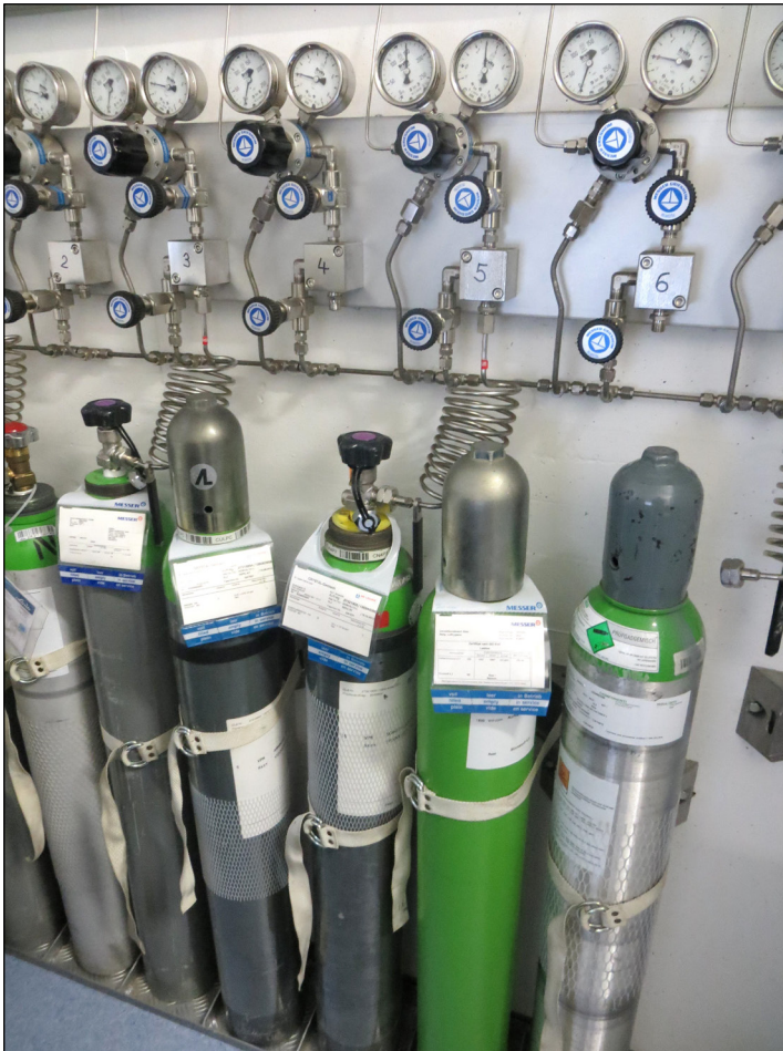
Abbildung 4: Versorgungsstation der Gasmischanlage mit Prüfgasen und Interferenzen. (© Umweltbundesamt)
