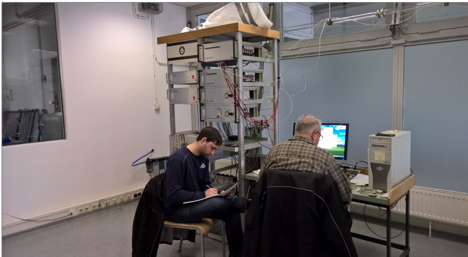
Abbildung 92: Nebenräume für die Anlagensteuerung und Datensicherung, (© Umweltbundesamt)
